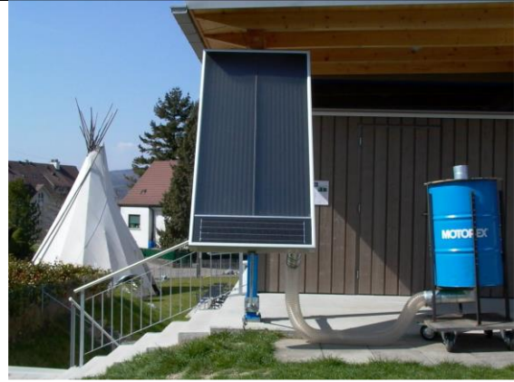
Versuchsstation 6 und 6b: Der Warmluftkollektor mit dem angeschlossenen Dörrfass
